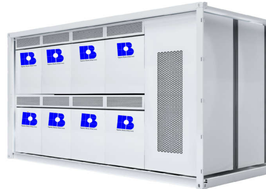
総合蓄電池システム(PCSと変圧器搭載)
